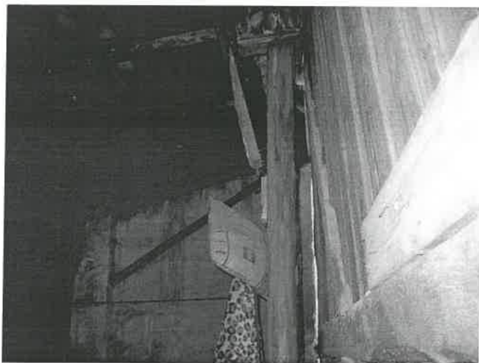
Fot. nr 7. Słup drewniany podpierający zarwane nadproże.
