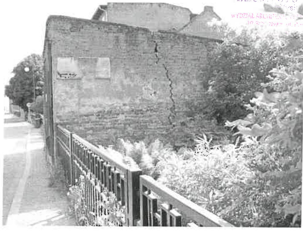
Fot. nr 4. Pionowe rozwarstwienie ściany bocznej - północnej.
