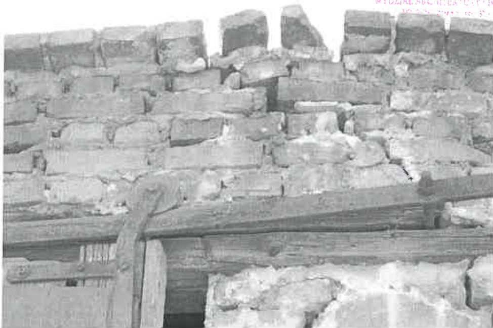
Fot. nr 2. Drewniane nadproże bramne, prowadnica bramy, rozwarstwiony mur.
