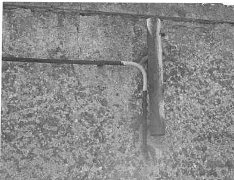
Fot. nr 5 pionowe pęknięcie ściany na styku z garażem sąsiada.
